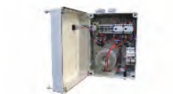
13 Cuadro eléctrico para motor cajón estanco
